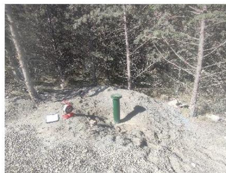
Vue de la tête du piézomètre Pz1-6
